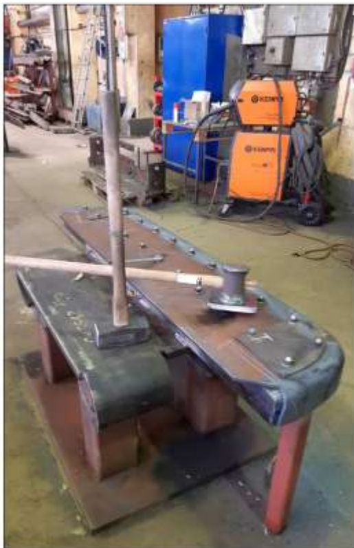
Här har den nya plåten till flamsugarens bakgavel monterats på en form som plåten ska smidas över till den rätta rundningen på gaveln. Plåten värms med gasolbrännare tills den har rätt temperatur för att kunna smidas.
