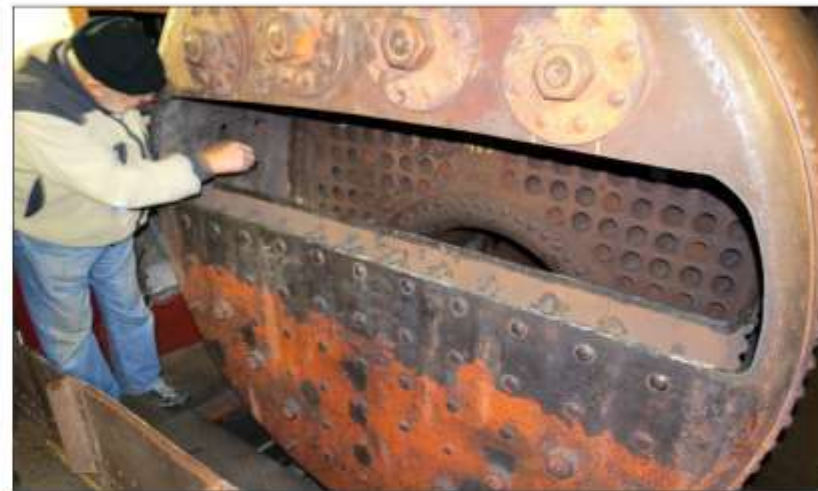
Bert Johansson tittar in i den uppkurna bakgaveln på pannan. Innanför den syns en rad med stagbultar som håller flamsugarens bakgavel, där övre delen samt tak och en bit av sidorna är bortskurna. Tubplåten rökgastuber och åldrör syns längst in. Foto Gunnar Söderberg 11 januari 2020.
